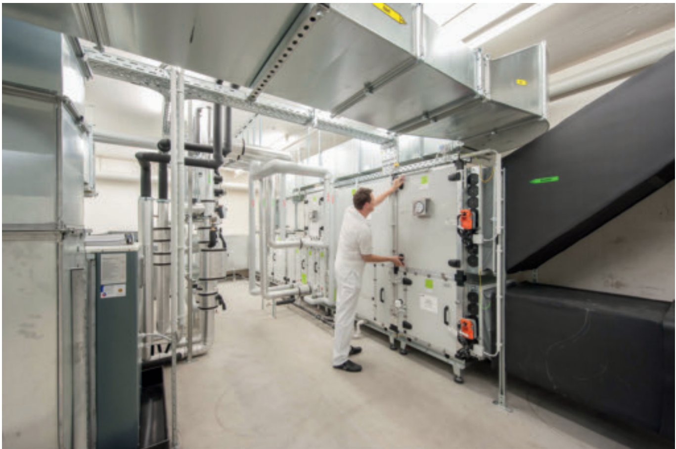
Abb. 5. Clean Room Lab im Kinderwunschzentrum Baden: Grossvolumige Lüftungsanlage mit Kontrollsystem
